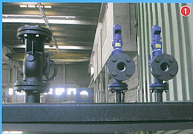
PRESA VAPORE E DUE VALVOLE DI SICUREZZA STEAM INTAKE AND TWO SAFETY VALVES
