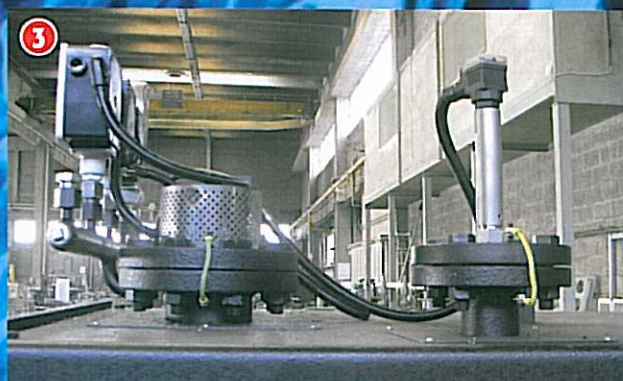
GRUPPO TRE SONDE LIVELLO E SICUREZZA CON UNA SONDA FAIL SAFE (OPTIONAL) THREE LEVEL AND SAFETY PROBES UNIT WITH FAIL SAFE PROBE (OPTIONAL)
