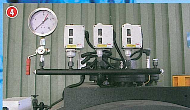
4 GRUPPO CONTROLLO PRESSIONE CON PRESSOSTATI DI REGOLAZIONE E DI SICUREZZA (OPTIONAL TRASDUTTORI DI PRESSIONE) PRESSURE CONTROL UNIT WITH SAFETY AND ADJUSTMENT PRESSURE SWITCHES (PRESSURE TRANSDUCER OPTIONAL)
