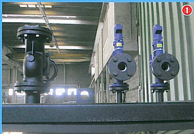
1 PRESA VAPORE E DUE VALVOLE DI SICUREZZA STEAM INTAKE AND TWO SAFETY VALVES
