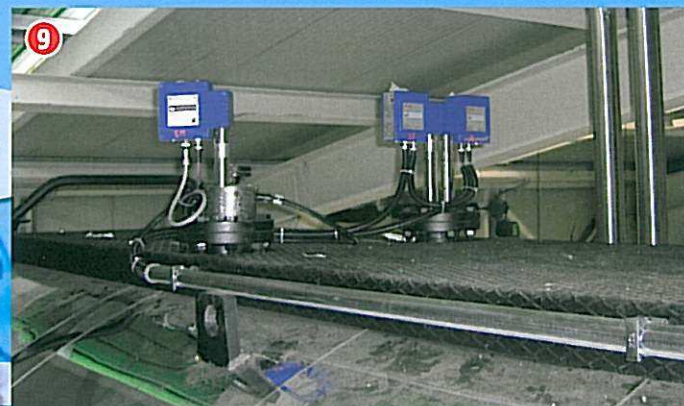
N. 2 SONDE LIVELLO MINIMO FAIL SAFE PER ESENZIONE 24 ORE, TERZA SONDA FAIL SAFE LIVELLO MASSIMO PER ESENZIONE 72 ORE
