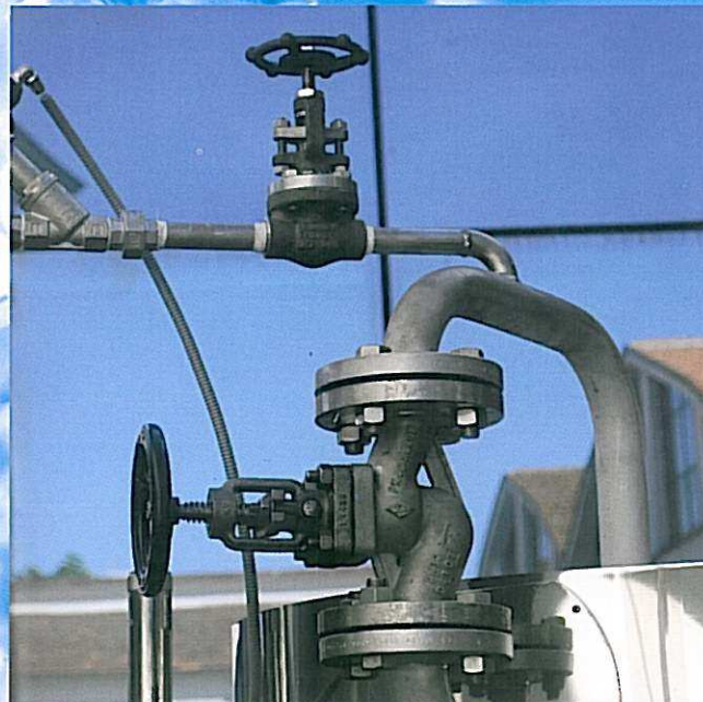
PARTICOLARE SURRISCALDATORE DI VAPORE E VALVOLA DI INTERCETTAZIONE DETAIL OF STEAM OVERHEATER AND ON/OFF VALVE
